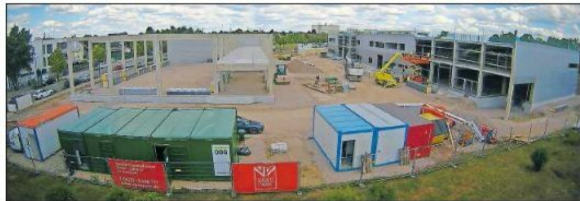
Eine Webcam dokumentiert den Baufortschritt auf dem Variopark-Grundstück an der Adam-Opel-Straße – hier eine Aufnahme von Ende Mai. FOTO: VARIOPARK/GRATIS
