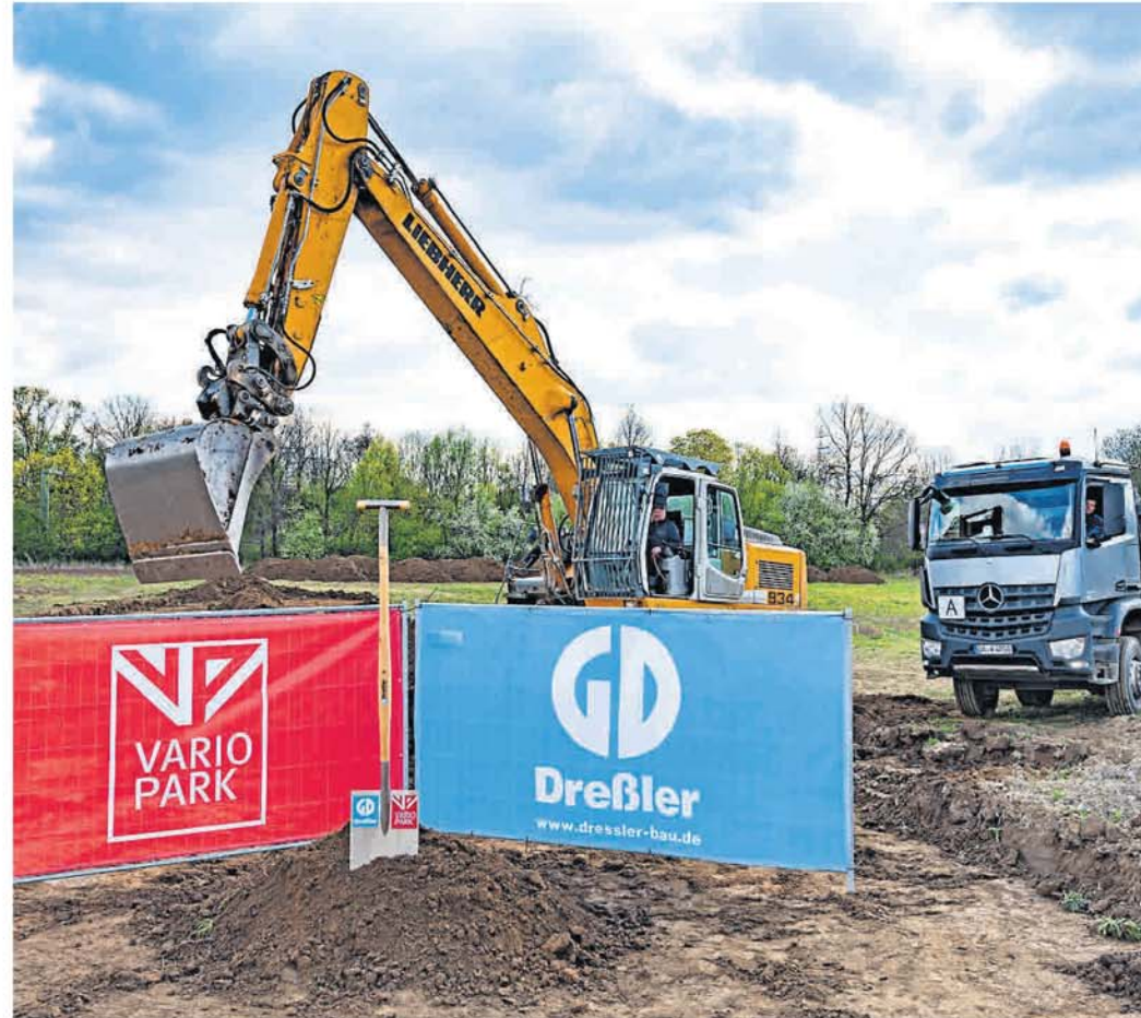
Spatenstich ganz ohne Publikum: Die Bauarbeiten für den Vario Park an der Bruchwiese haben begonnen. Foto: Vario Park
